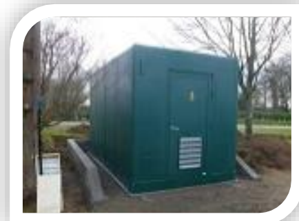
Exemple de Shelter
